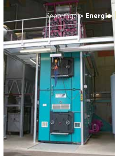
2 MW-Polytechnik-Anlage bei Gaulhofer in Übelbach
